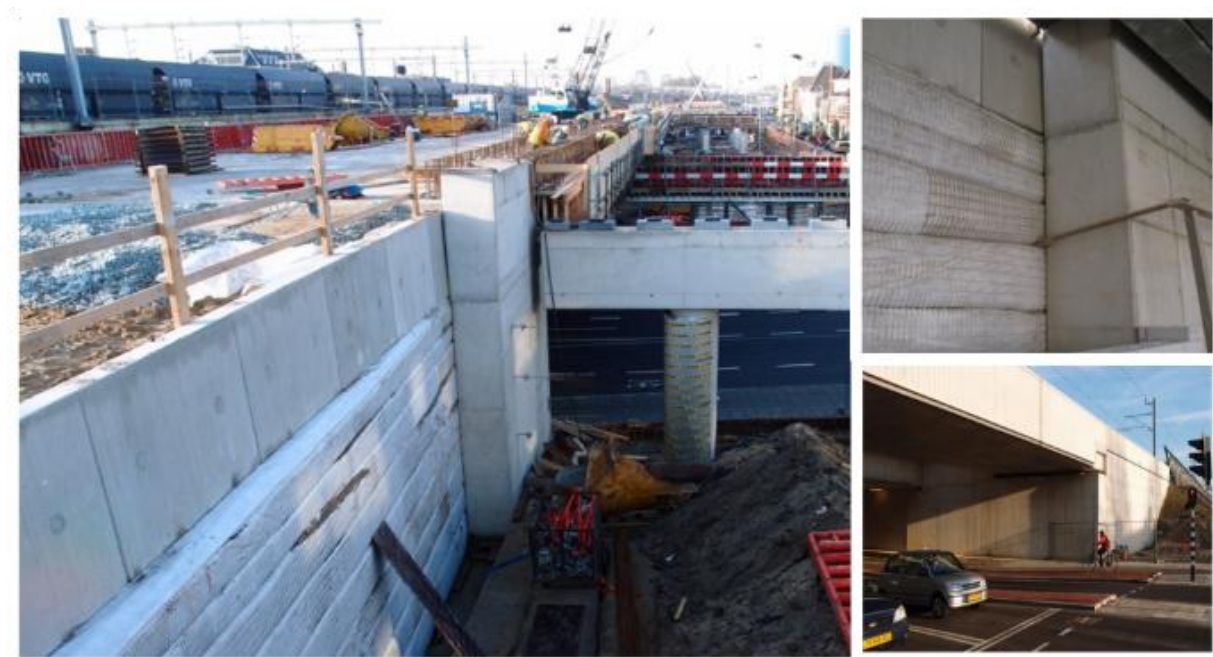
Abbildung 11: KBE als Permanentkonstruktion unter Eisenbahnverkehrslasten und als innenliegender Erddruckfänger hinter einem Brückenwiderlager (Utrecht, Niederlande).
