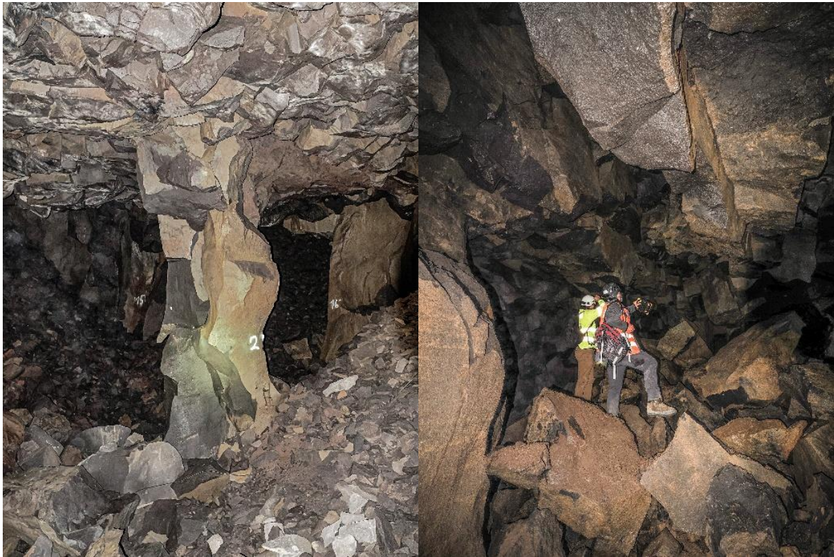
Abbildung 2: Linkes Bild: Vielfach zerbrochener Basaltpfeiler in einem Hohlraum nahe der Straße Am Layerhof. Der Pfeiler weist eine Höhe von etwa 5 m auf (Foto vom 20.07.2023, A. Wehinger). Rechtes Bild: Firste unter der Straße Am Layerhof. Hier ereignete sich ein Hochbruch bis wenige Meter unter die Geländeoberfläche. Nach dem Antreffen des Hochbruchs im Rahmen der Erkundung wurde die Straße unmittelbar gesperrt und der betroffene Hohlraum im Rahmen einer Sofortmaßnahme verwahrt (Foto vom 20.07.2023, A. Wehinger).
