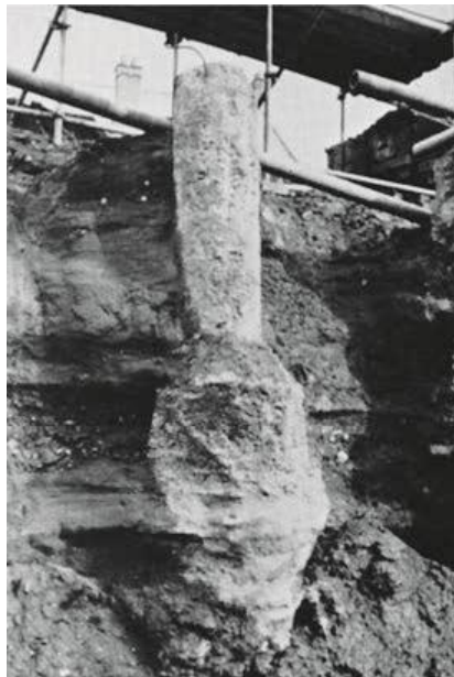
Abbildung 1: Schaden infolge des Abfließen von Beton in einen trockenen Hohlraum (Foto von CIRIA, London) (Fleming, 2009).
