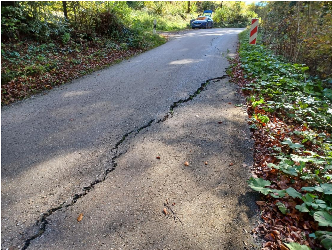
Abbildung 4: Rissbildung in der Straße.
