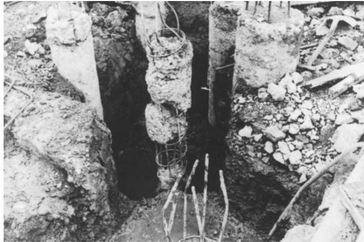
Abbildung 2: Schaftdefekt eines Bohrpfahls infolge von Zementauswaschung im frühen, noch nicht erstarrten Stadium des Betonierens (Tomlinson, 2015).
